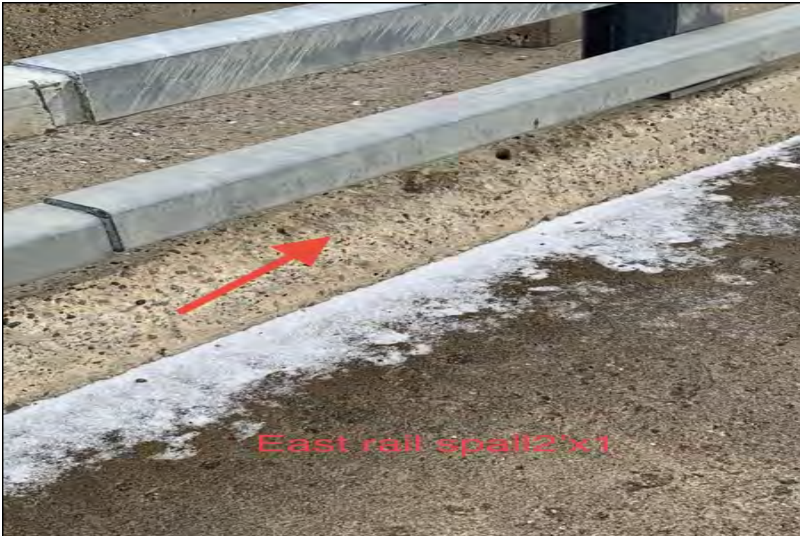
East curb spall 2'x1'
