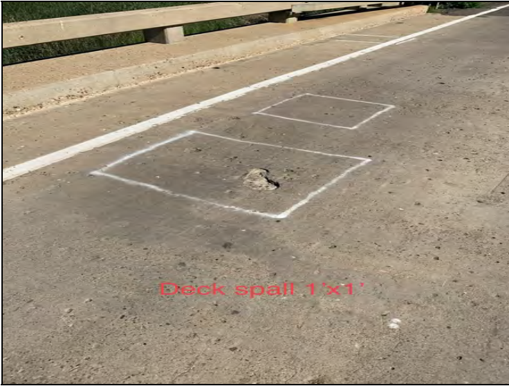
Deck spall 1'x1'
