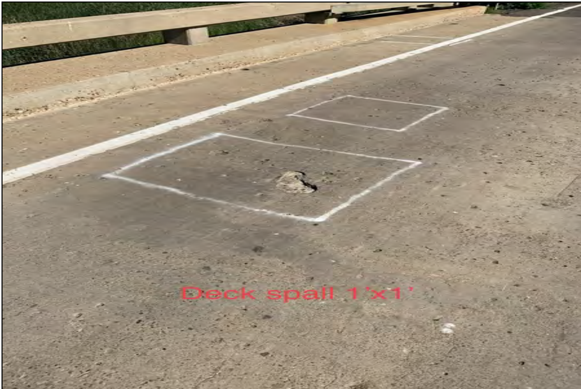
Deck spall 1'x1'
